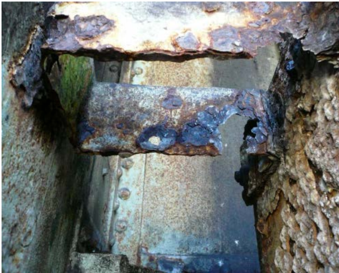
Buton entièrement corrodé
