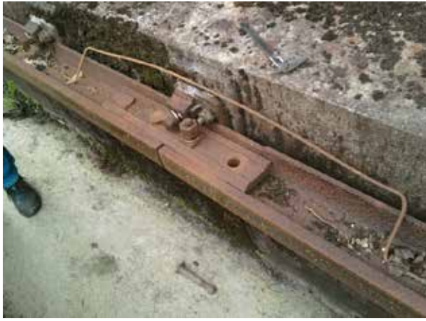
État d'un rail de guidage contrepoids
