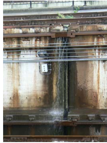
Rails de guidage bac et contrepoids
