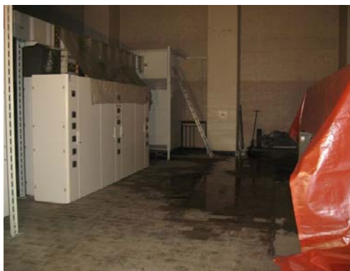
Venues d'eau dans les locaux techniques de la tour
