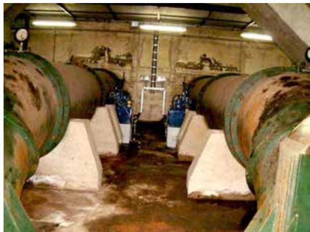
Viesville - Tuyauteries de rejet de pompage
