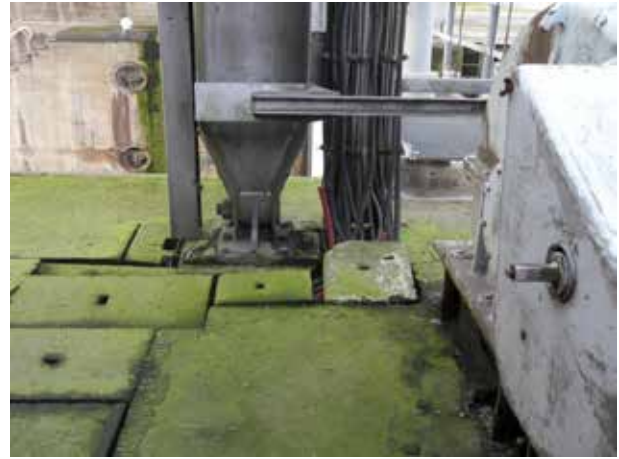
Marchienne - Caniveau et échelles à câbles
