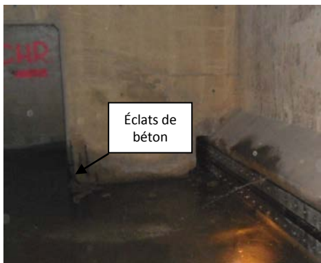
Éclatements des bétons à l'intérieur des bajoyers
