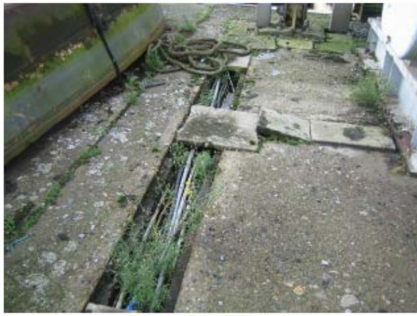
Marchienne - Caniveau à câbles
