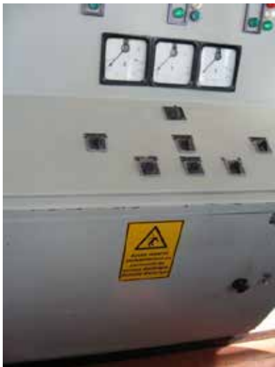
Viesville - Pupitre de commande, sur armoire électrique
