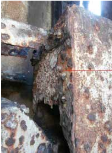
Tôle fortement endommagée
