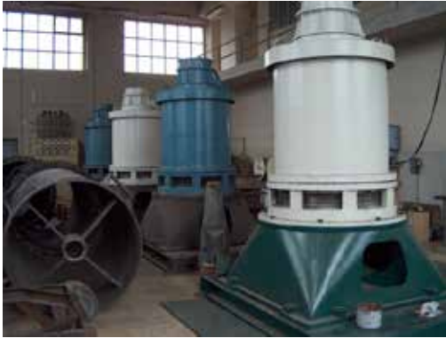
Moteurs des pompes
