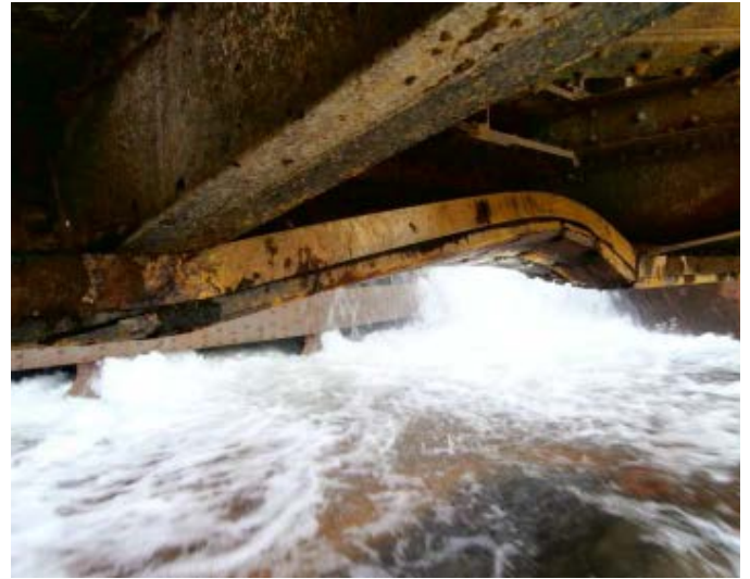
Fuites due à la déformation excessive des étanchéités
