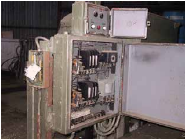
Marchienne - Commande évacuateur
