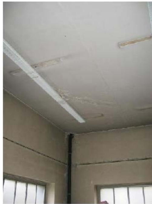
Viesville - Infiltrations d'eau
