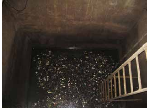
Viesville - Puit de pompage encrassé
