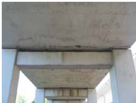
Infiltrations d'eau au travers des surfaces en béton, corrosion des armatures et éclatements du béton.
